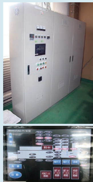
▲塗装制御盤と制御パネル▲
