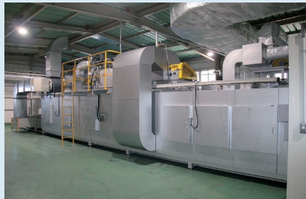
▲電気・ガス併用のハイブリッド乾燥炉▲
