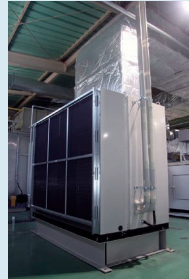
▲塗装ブース用の室内空調機
